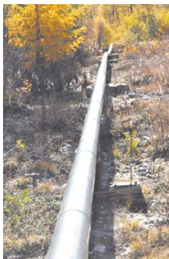
Трубопровод холодного водоснабжения
