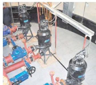
Современное оборудование на КНС фирмы «Grundfos»
