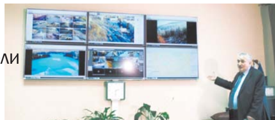
Центральный пульт системы «Безопасный город»
